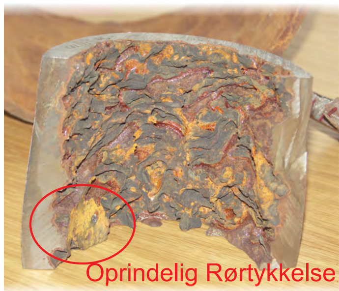
Figur 3: Et eksempel på mesa angreb hvor røret er korroderet i flager. Den originale rørtykkelse ses nederst til venstre.
