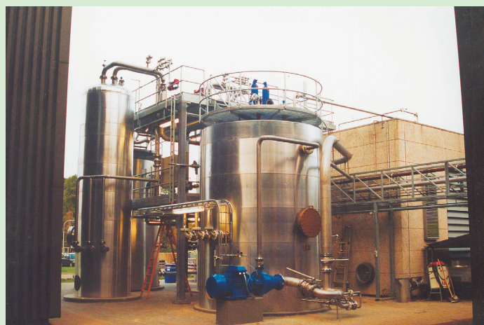
Det termiske hydrolyseanlæg på Fredericia Centralrenseanlæg. Kapacitet 40.000 tons slam pr. år.
