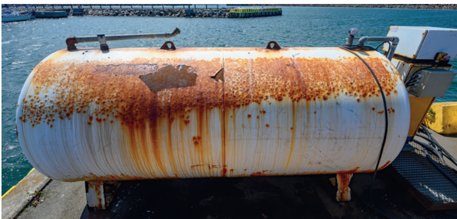
Figur 1. Korroderet dieseltank på Anholt. Foto af Torben Rasmussen, CoaST, DTU Kemiteknik.
