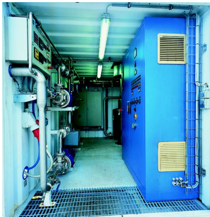
Figur 4. Et kig ind i en container med et ozonbehandlingsanlæg.
